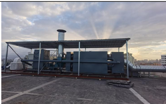
图 3-4 废气处理设施图
