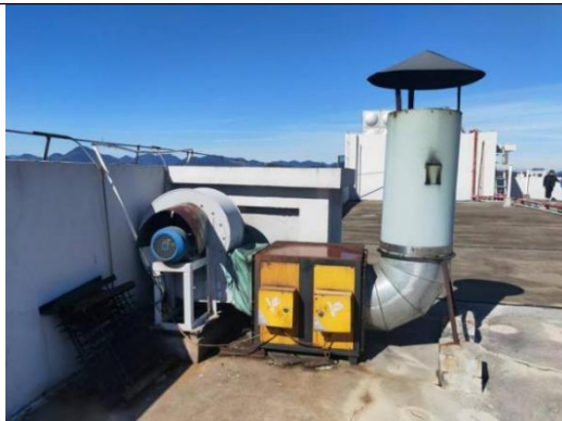
图 3-10 食堂油烟废气处理设施图
