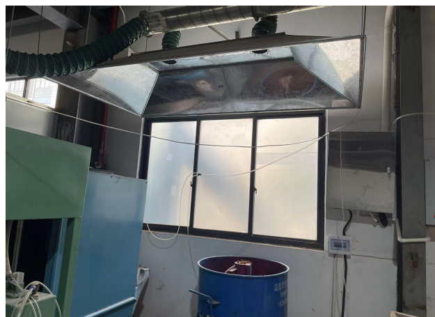
混砂粉尘收集
