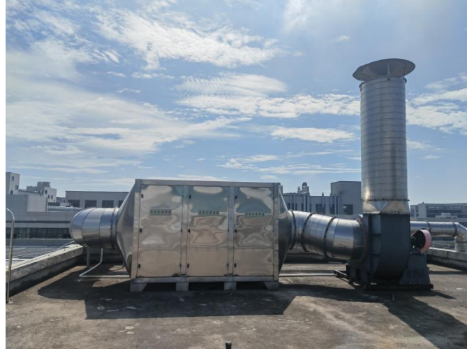
图 3-5 塑化废气、造粒废气处理设施图
