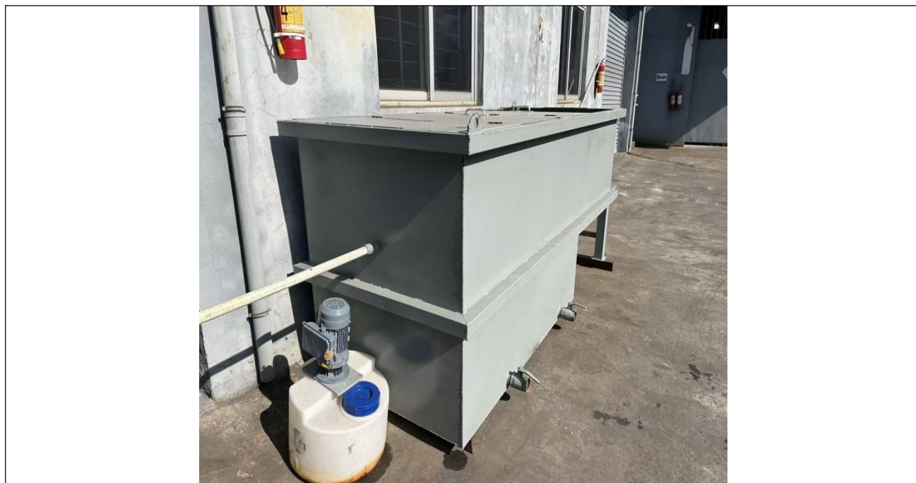
图 3-2 生产废水处理设施图
