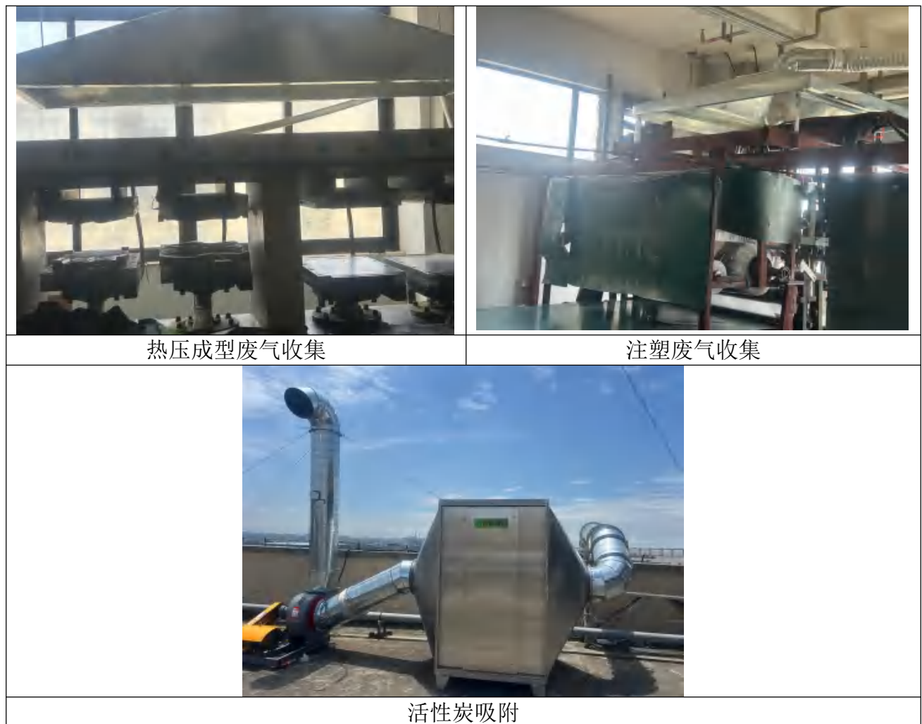
图 3-2 注塑、热压废气处理设施图
