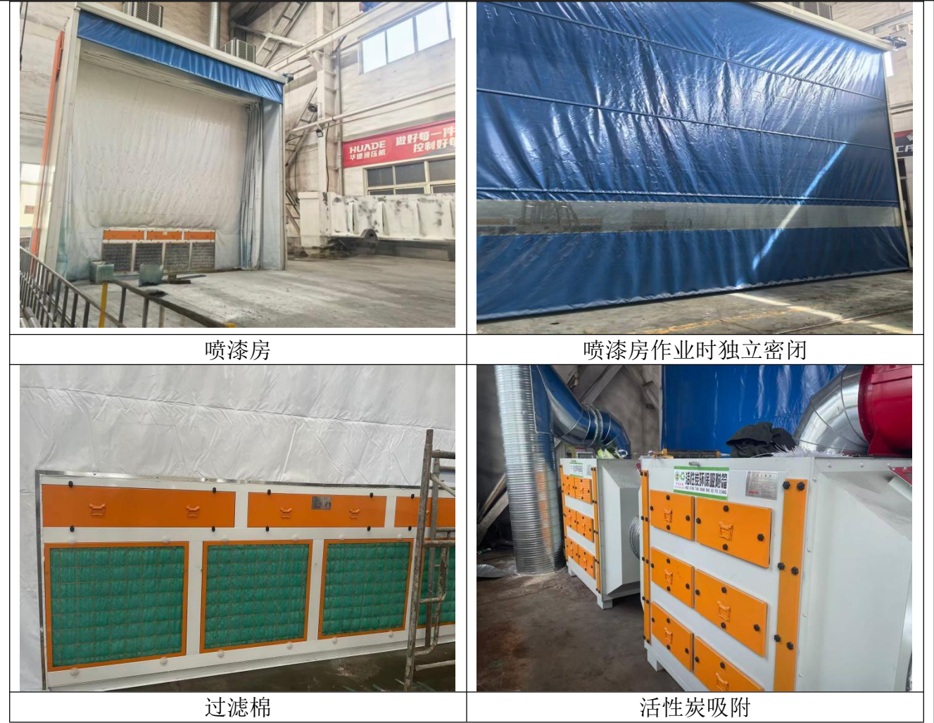
图3-3 涂装废气处理设施图
