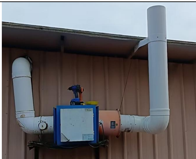
图 3-5 食堂油烟废气处理设施图
