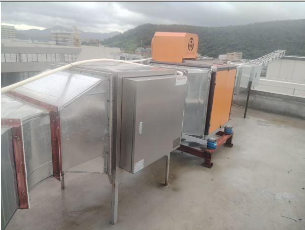
废气收集（高效油烟净化器）
