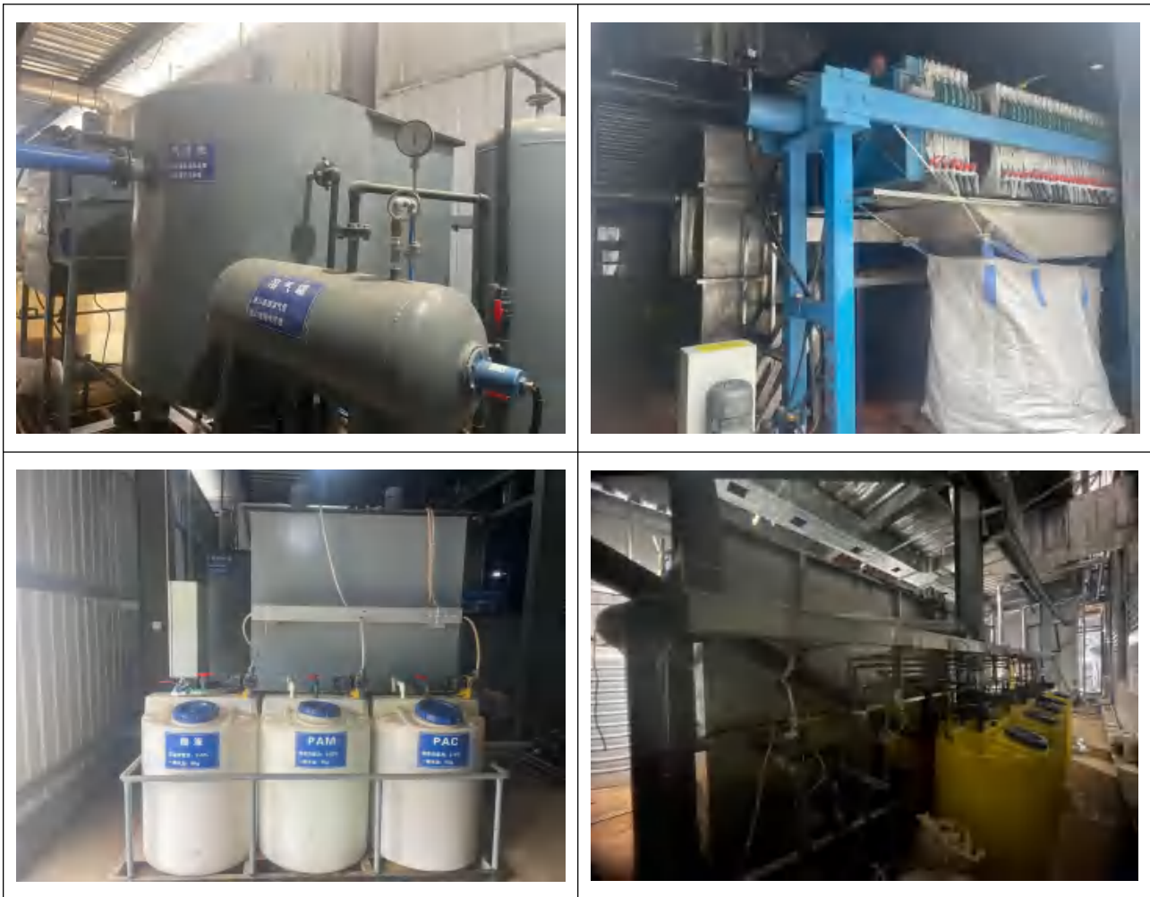
图4-2 生产废水处理设施图
