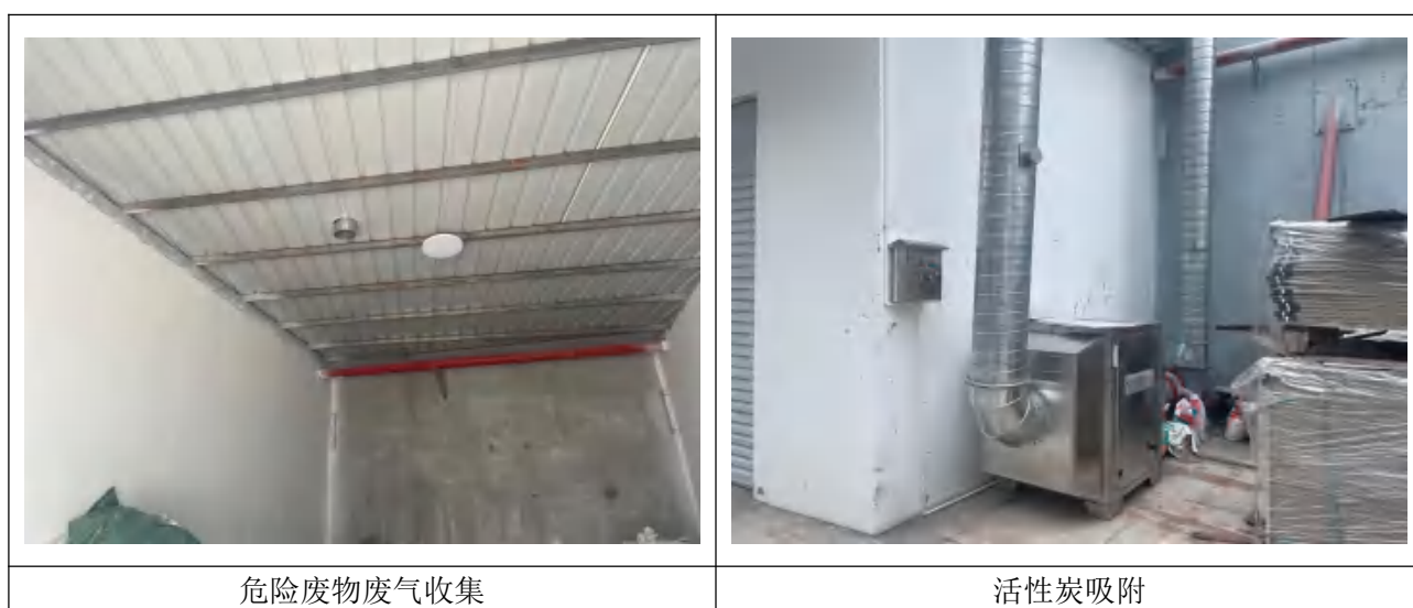
图 4-21 危险废物废气处理设施图
