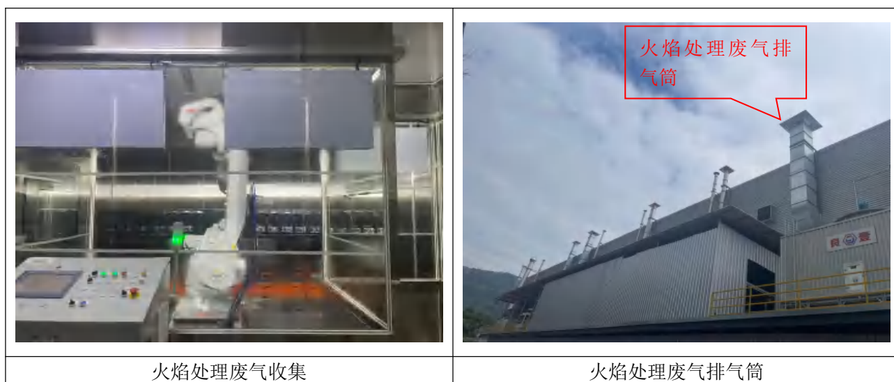
图 4-19 火焰处理废气排气筒图
