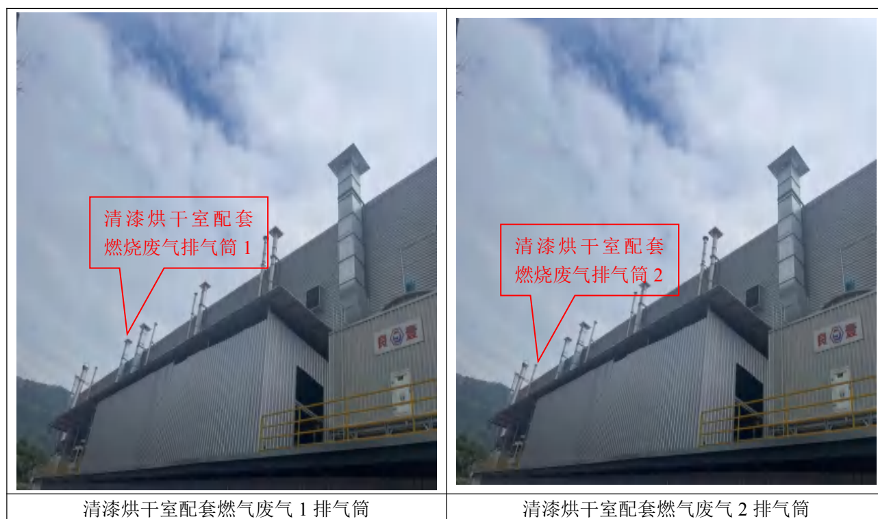
图 4-15 清漆烘干室配套燃烧废气排气筒图
